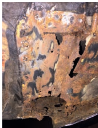
Korrosion an Schweller, Bodenblech und Schwellerdeckel
